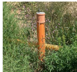
Fot. 2 Studzienka Z8 na składowisku odpadów innych niż niebezpieczne i obojętne w m. Zakroczym
