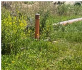
Fot. 1 Studzienka Z3 na składowisku odpadów innych niż niebezpieczne i obojętne w m. Zakroczym
