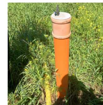
Fot. 3 Studzienka Z10 na składowisku odpadów innych niż niebezpieczne i obojętne w m. Zakroczym
