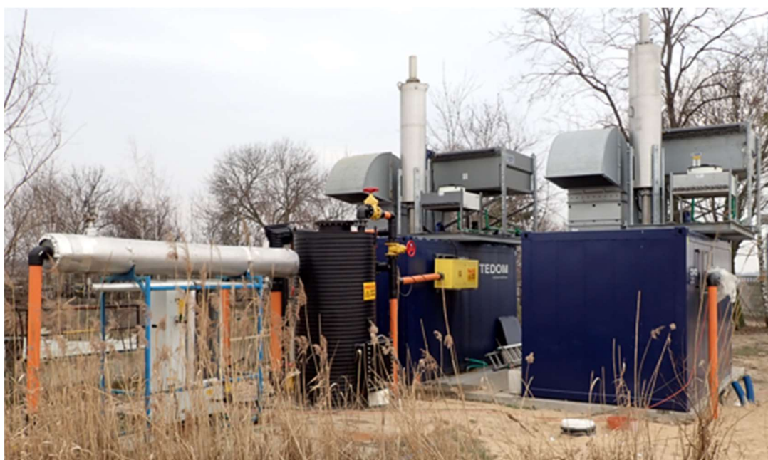
Elektrownia biogazowa - dwa agregaty kogeneracyjne i system doczyszczania gazu
