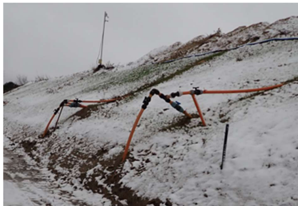
Punkty pomiarowe na gazociągach
